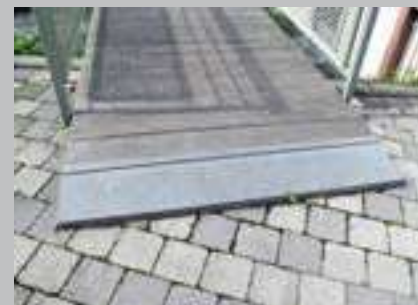
✗ Ressaut au départ de la voie d'accès
