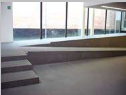
❌ Absence de mains-courantes de part et d'autre de la rampe (et de l'escalier)
