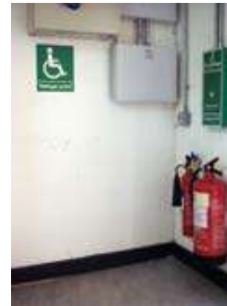
✓ Extincteur placé à bonne hauteur
