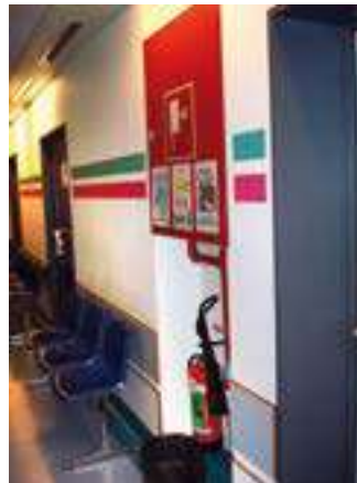
✓ Extincteur placé dans une niche
